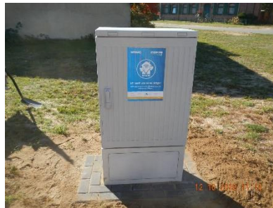
Abb. 3: KvZ Schleuse Neuburg
